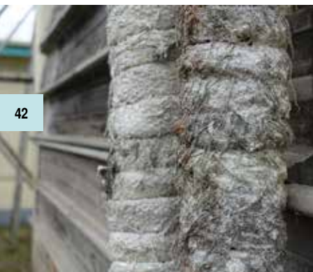
Des cordes d'isolation à l'amiante retrouvées au cours du sondage de PacWaste concernant l'amiante. Photo : PROE/E. Vanerburg
